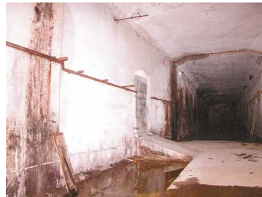
Fragment tunelu metra głębokiego, budowanego w l. 50. XX w., rejon ul. Mieszka 1
