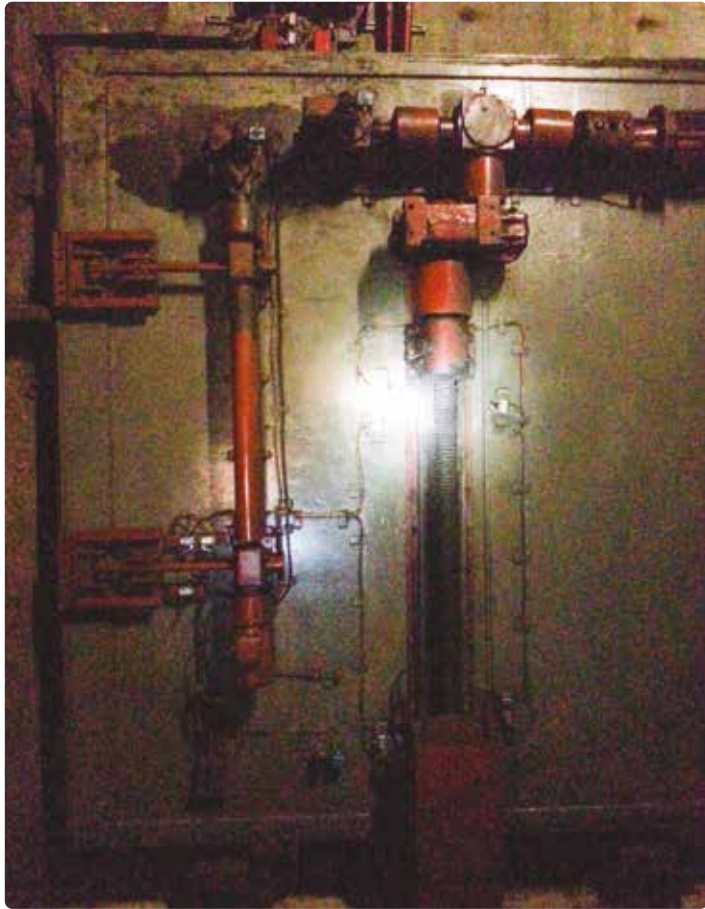
Siłownik wrót między stacjami metra Ursynów a Służew
